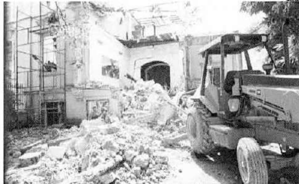
A presença de um trator e as pedras destruídas de um casarão de Largo da Graça chamaram a atenção dos moradores.
